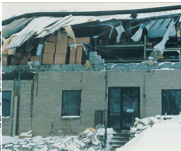
Téli viharban megrongálódott tetőszerkezet [9]
