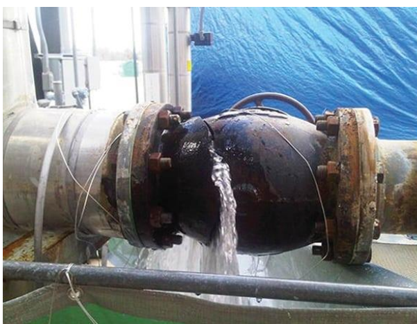
A 2011. évi texasi hidegben eltört tűzivíz vezetéki zárószerelvény [12]
