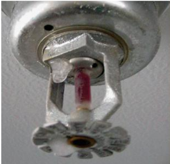
Elfagyott sprinkler szórófej [8]
