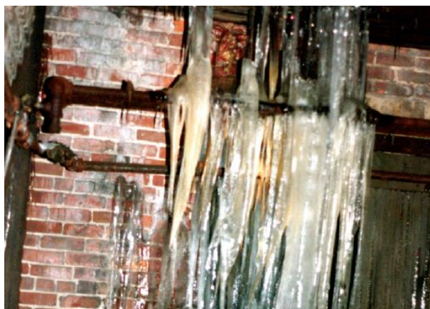
Az üres üzemi épület elégtelen fűtése kiterjedt fagykárt okozott [10]
