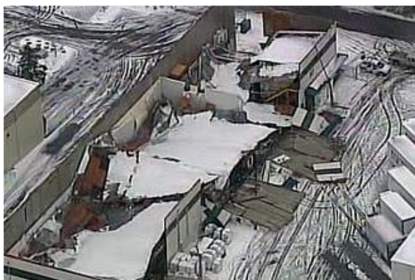
Üzemi épületek beszakadt tetőszerkezetei [1]
