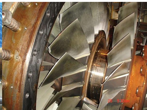
Kompresszorlapátok sérülése korábban fel nem tárt vízvezeték lyukadása miatt, amely jégképződést eredményezett a hidegben [12]
